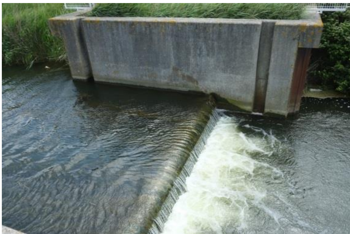
Clapet de Marck en position partiellement levée
