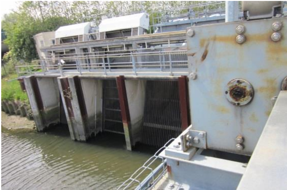
Dégrilleurs de la station des Pierrettes
