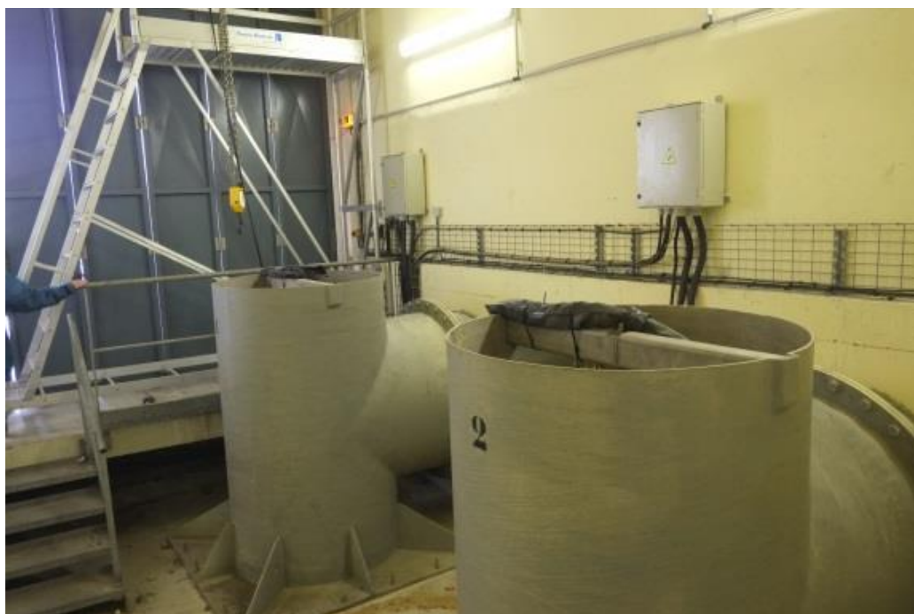
Pompes Flygt de la station Batellerie
