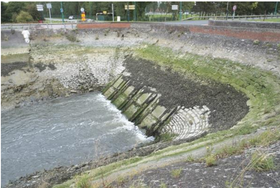
Exutoire du Schelfvliet – Clapets en bois
