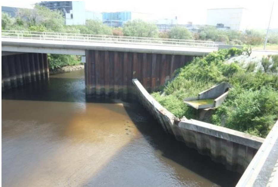
Déversement du rideau de palplanche en amont de la station de Marck
