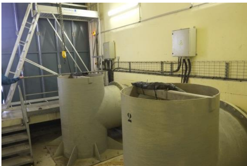
Pompes Flygt de la station Batellerie
