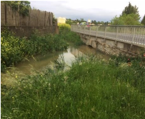
Pont du ruisseau de Séraut sur la RD620 au lendemain de la crue
