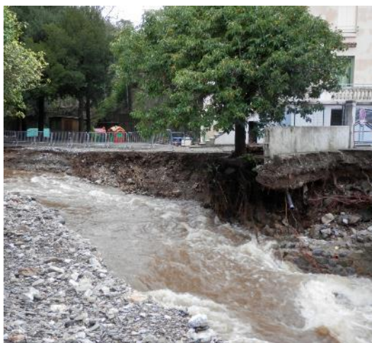
Mur de l'école de Lastours emporté par la crue de l'Orbiel en 2018
