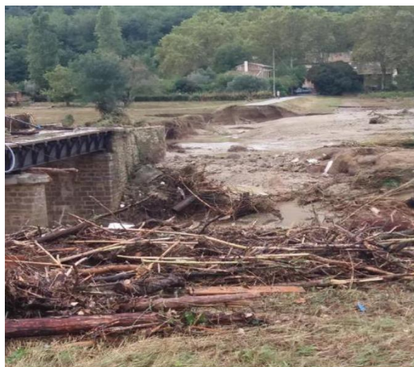
Dégâts de la crue de 2018 sur le Lauquet
