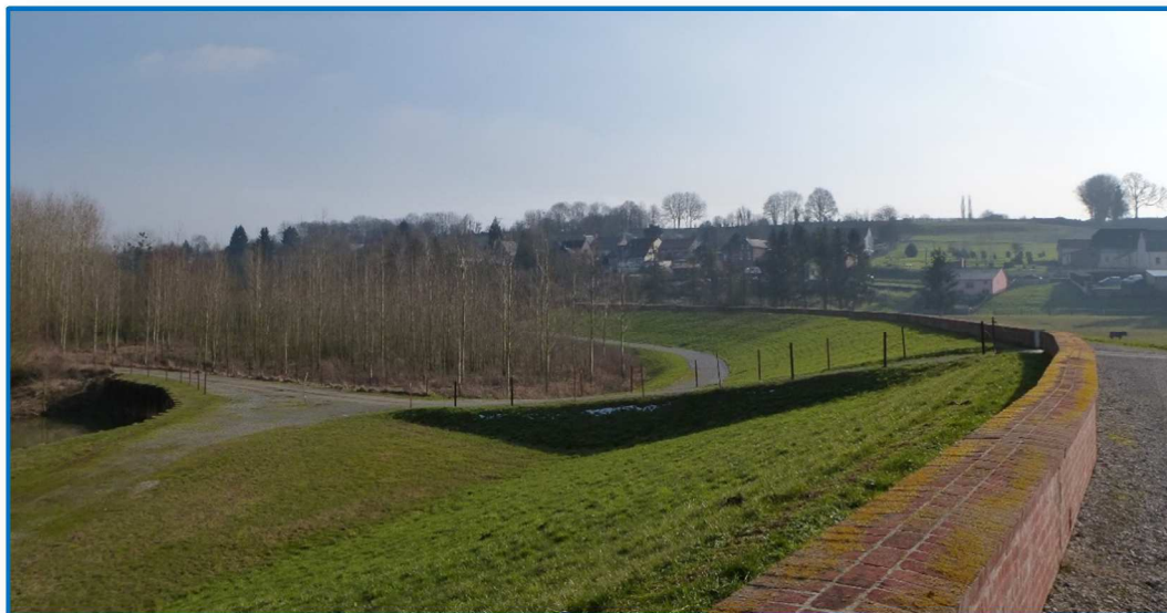
Figure 1 : Retenue sèche de Proisy (Aisne) sur la rivière Oise (P. Laugier – Entente Oise Aisne)
