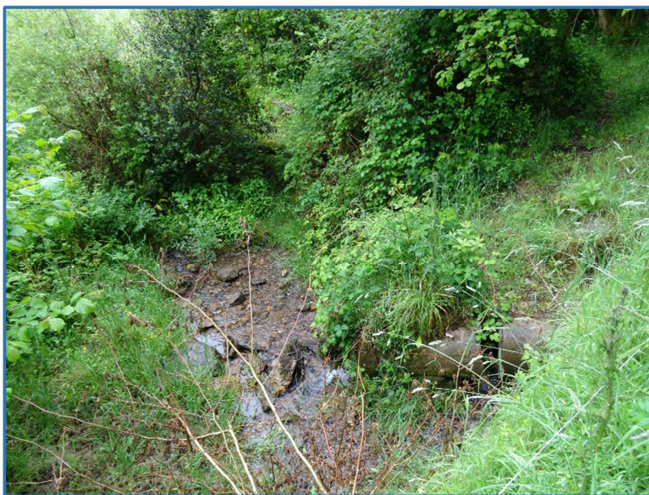
Figure 2 : Busage endommagé sur le ruisseau de Moulin Kerroc'h (P. Laugier –EPAGA)
