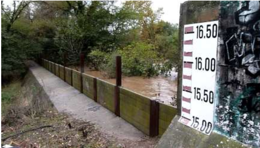
Figure 2. 76 – Déversoir du Plan du Pont (source : Mairie d’Hyères)
