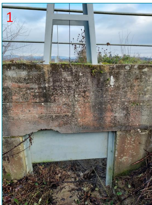
Figure 17. Ouvrage de décharge après la crue du 28/12/2020 (source : commune de Sérignac)
