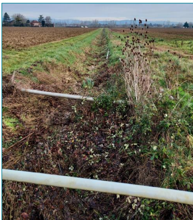
Figure 18. Vue du fossé en aval de l’ouvrage de décharge après la crue du 28/12/2020 (source : commune de Sérignac)
