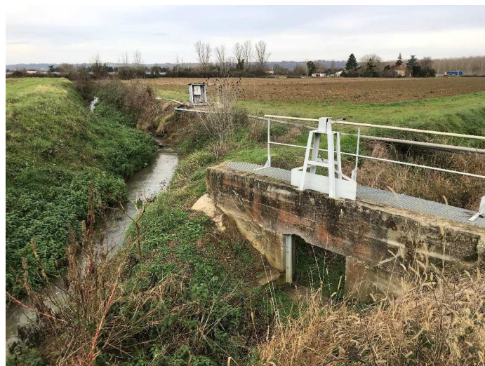
Vanne de décharge du Mongrenier en amont de Sérignac sur Garonne
