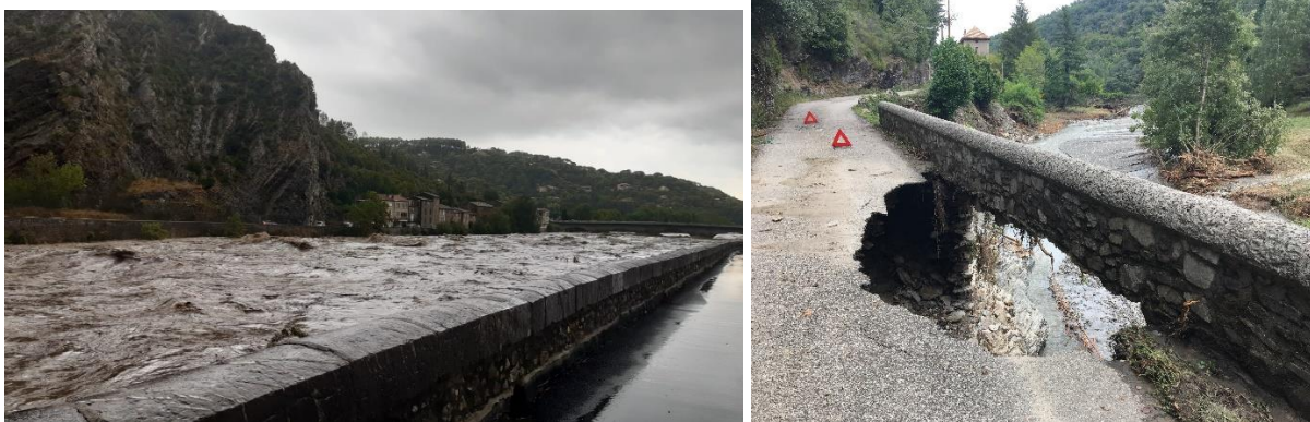
Gardon d'Anduze en crue et dommage en Cévennes
