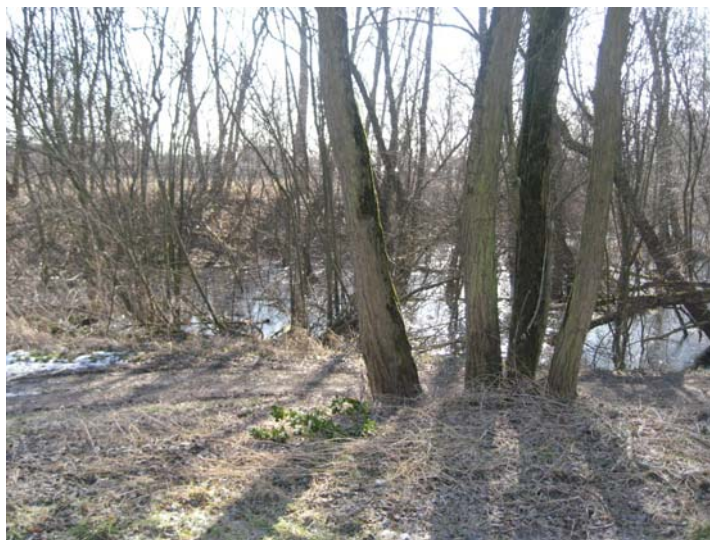
Figure 18 : Eaux stagnantes au pied de la digue 2.1
