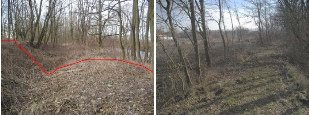
Figure 7 : ravinement au pied de la digue H et irrégularités de crête de la digue E
