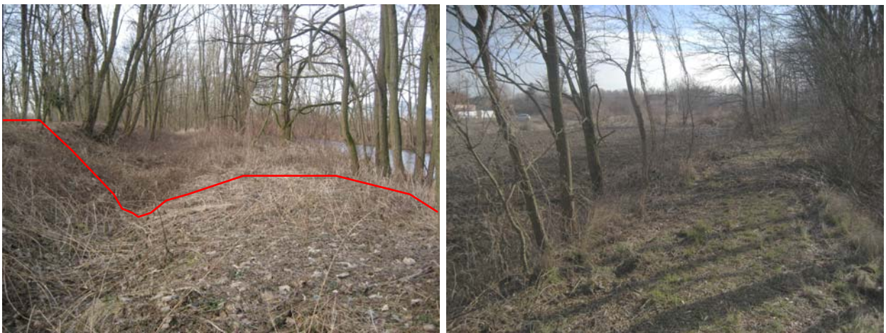
Figure 13 : Ravinement au pied de la digue H, et irrégularités de crête de la digue E
