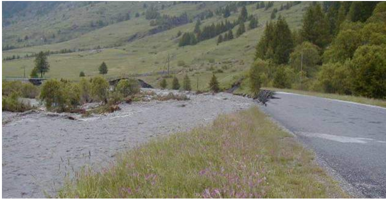
Photographie 8 : destruction de la route entre les hameaux de l'Echalp et le chef lieu de Ristolas – mairie de Ristolas, octobre 2000
