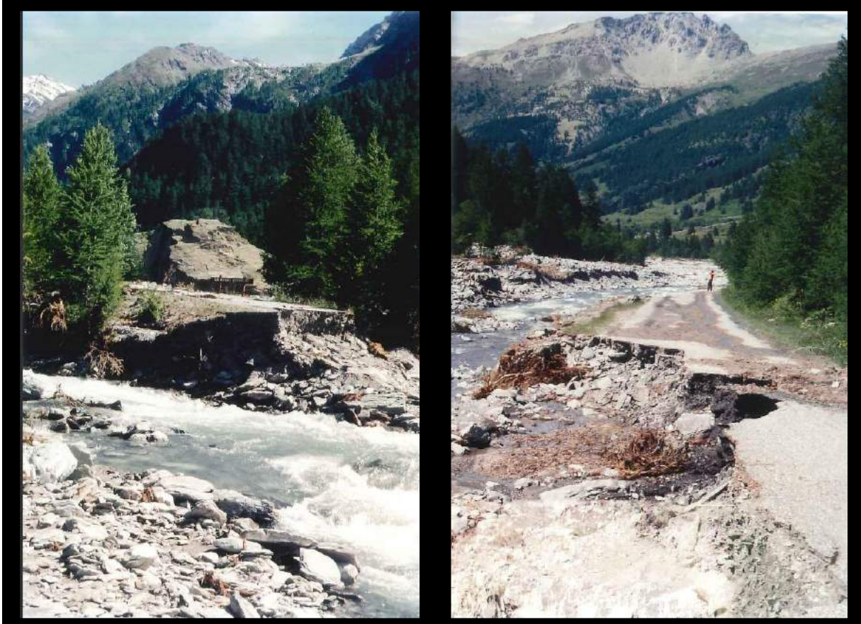
Photographies 5 et 6: destruction de la route sur la commune de Ristolas entre l'Echalp et la Roche Ecrulée – PNRQ, juin 2000
