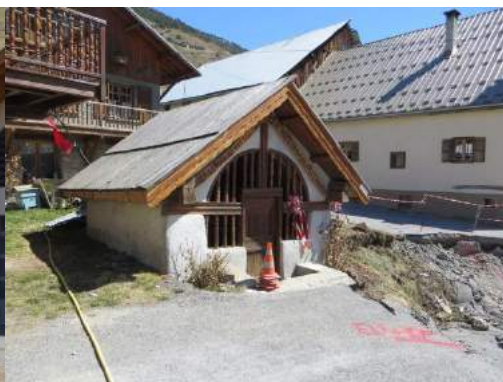
Oratoire de Ceillac (effondrement de gypse)
