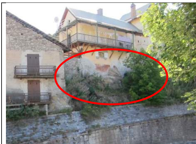
Photo 1 : Effondrement d'un mur de l'ancienne caserne en rive droite du Lombard. source : Benoit Carlier
