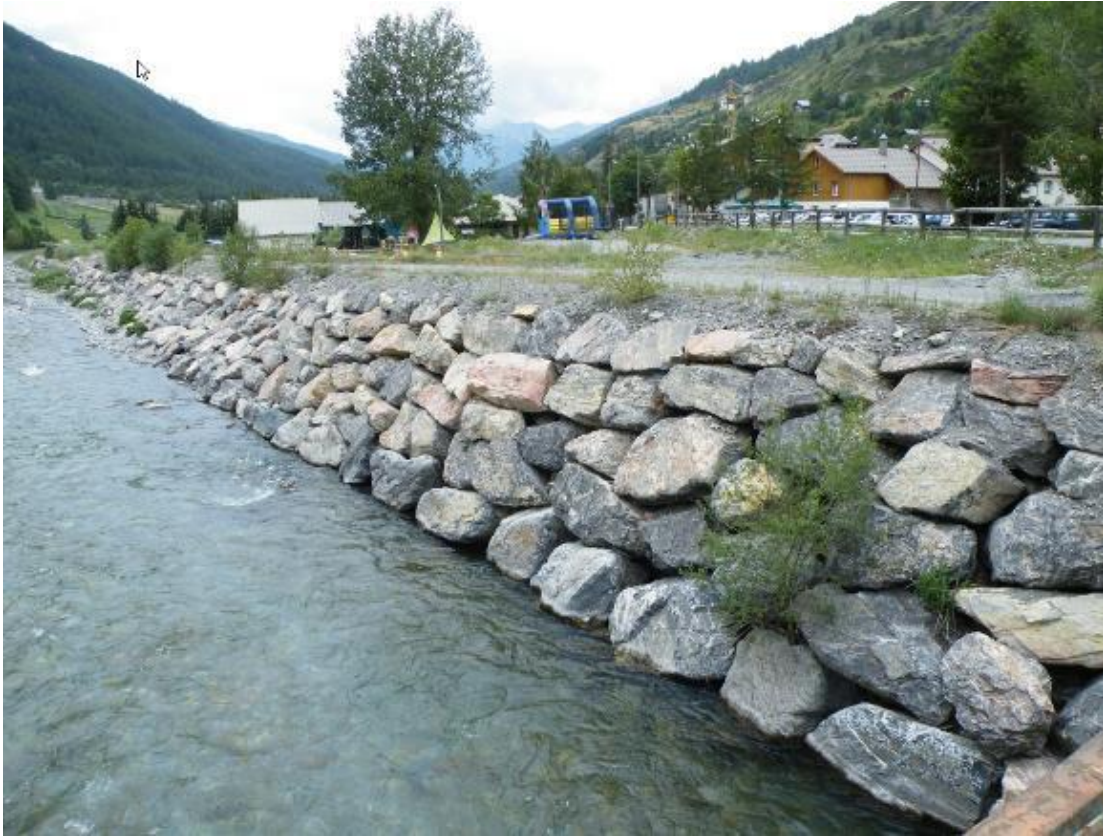
Photo 1 : protection de berges de la plaine des Ribes en rive droite du Guil et l'hôpital en arrière plan
