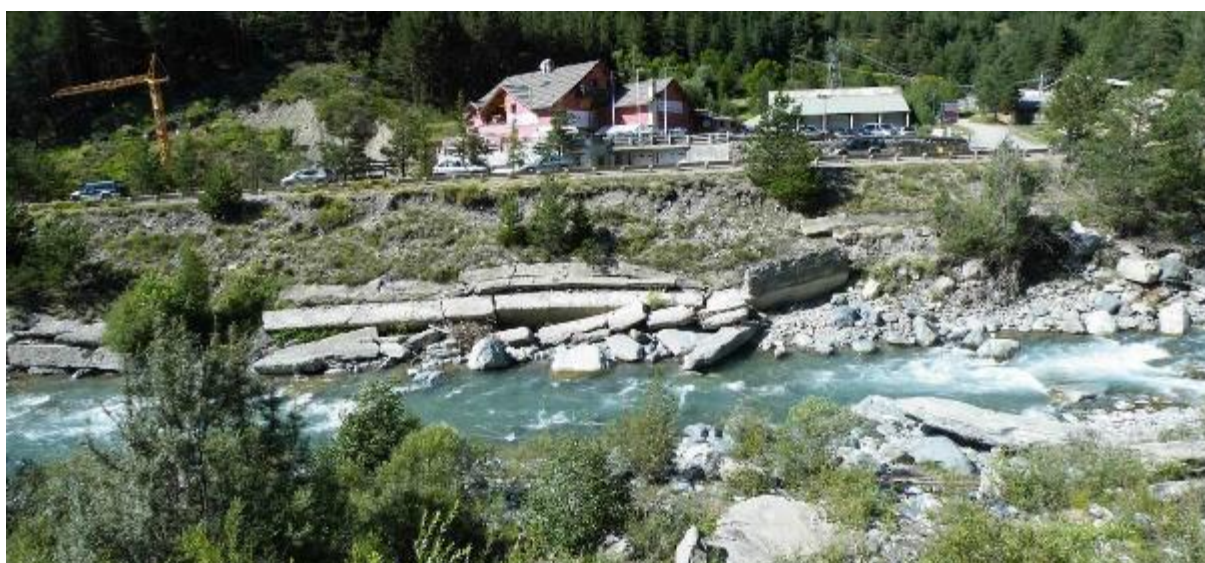
Photo 1 : Etat de la digue départementale (extrait du diagnostic de digue, RTM, 2016)
