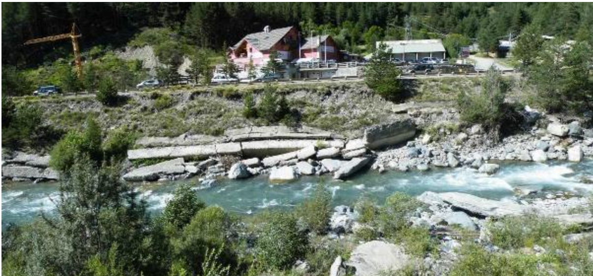
Photo 2 : Etat de la digue départementale (extrait du diagnostic de digue, RTM, 2016)
