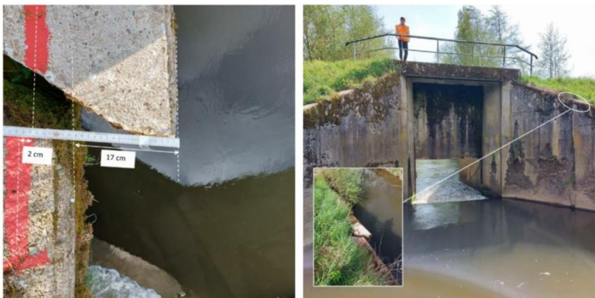
Figure 9: Basculement des bajoyers amont du limiteur de crue (ARTELIA, 2022)
