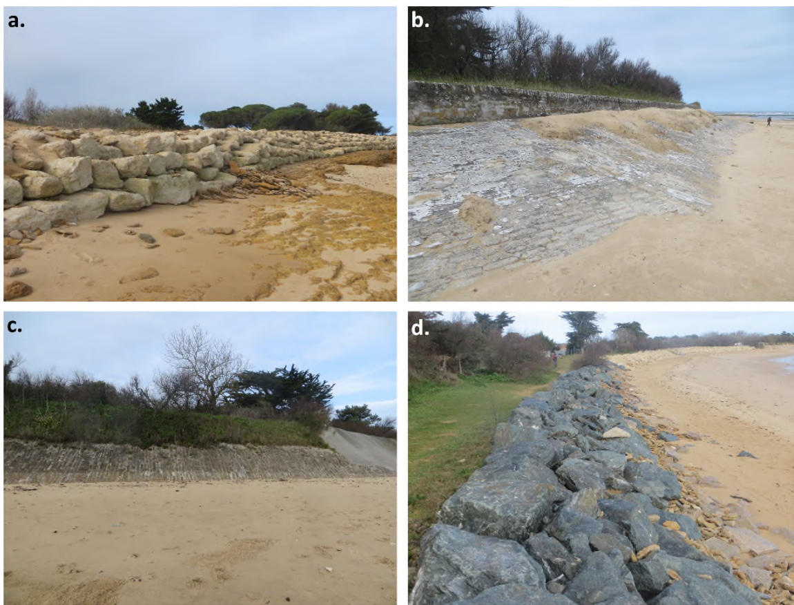
Figure 34 : Aperçus des ouvrages de protection de la façade maritime nord-est des Portes-en-Ré. a. Enrochements du secteur du Grand Marchais b. Digue maçonné des Marchais c. Digue maçonné de la Providence d. Enrochements de l'Anse du Fourneau (source : ARTELIA, 2018)
