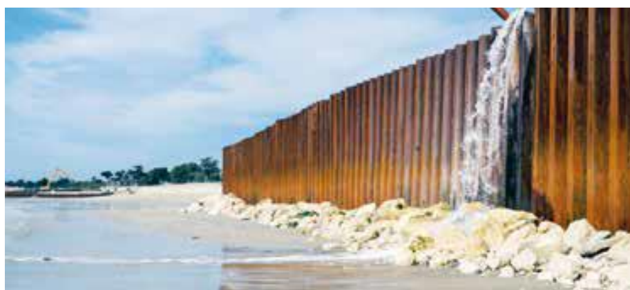
Mise en œuvre de palplanches afin de mettre hors d'eau la zone de chantier
