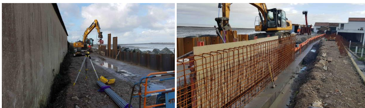
Mise en œuvre des palplanches et du muret sur le secteur de la Moulinatte
