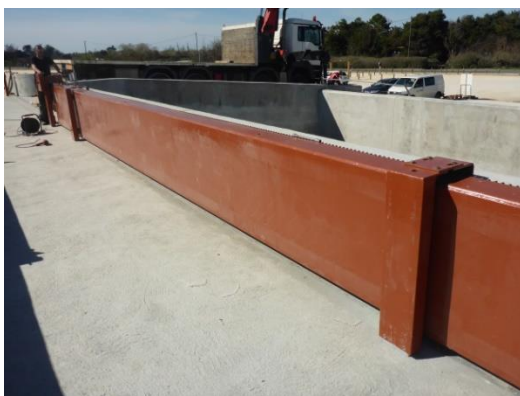
Portail coulissant situé en haut du pas d'accès
