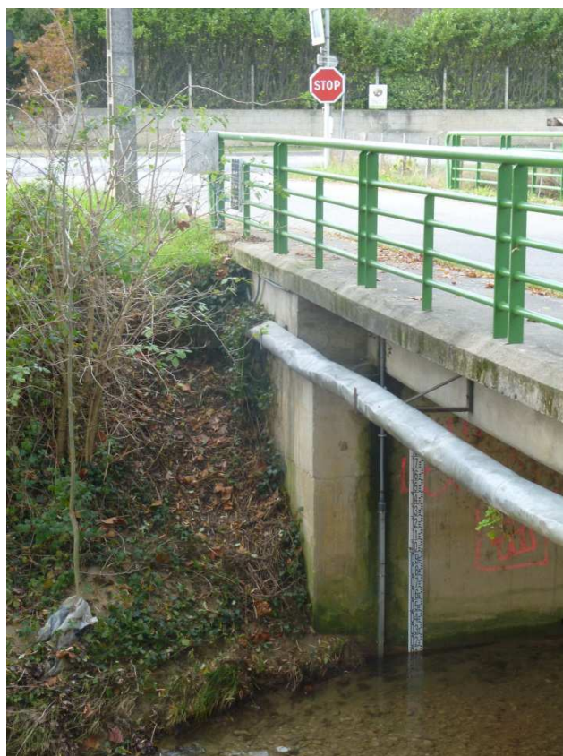
Photo 1 : Station des Plantards destinée actuellement au suivi d'étiage. Cette station sera confortée dans afin de suivre les débits de pointe dans le cadre du PAPI.
