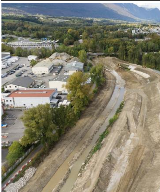
Plus en aval, travaux d'élargissement et de confortement de la digue rive droite. Dévoiement des réseaux pour les sortir de la digue. Création de la nouvelle piste cyclable, plus proche du cours d'eau. 2017.
