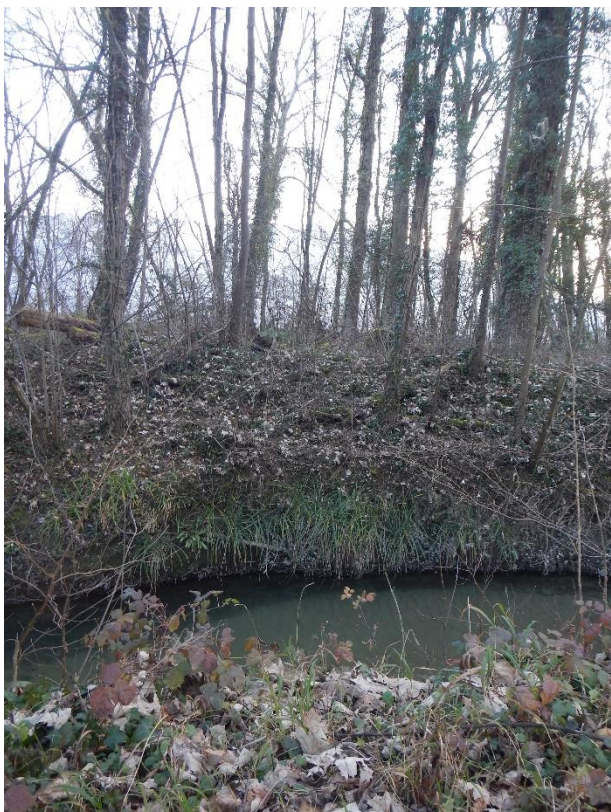
Photo 19: Déconnexion du lit du ruisseau des marais
