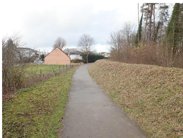
Vue de la digue sur son tronçon médian côté zone protégée (janvier 2020)
