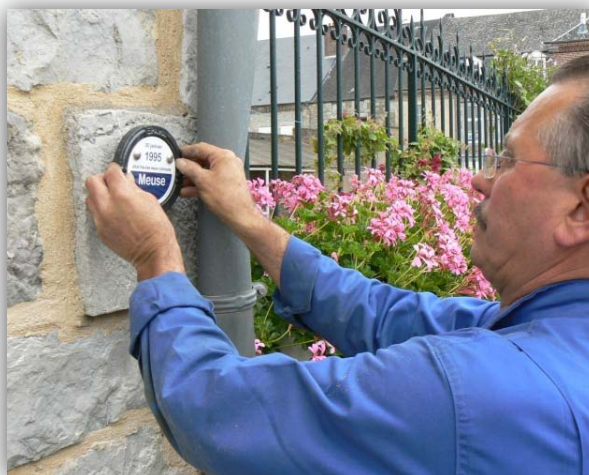
Photo 22 : Pose de repère de crue à Givet (EPAMA- EPTB Meuse, 2008)
