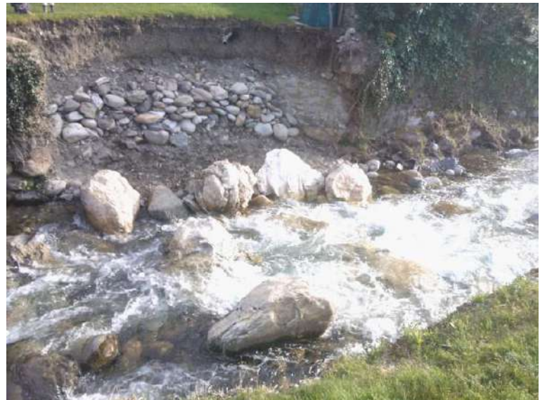
Rive gauche effondrée
