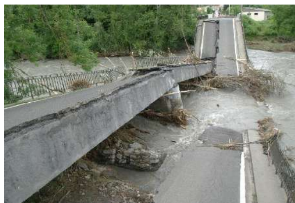
Figure 4 : Crue du 18 juin 2013 – Saint-Laurent-de-Neste
