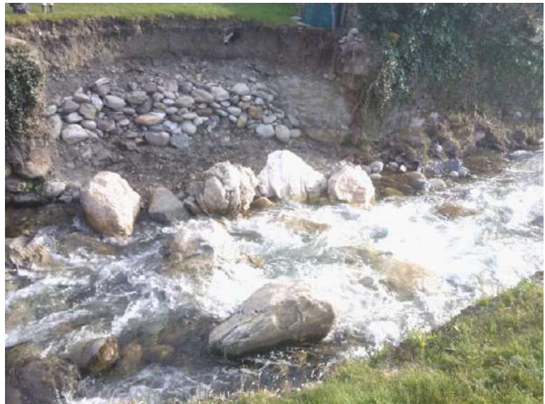
Rive gauche effondrée
