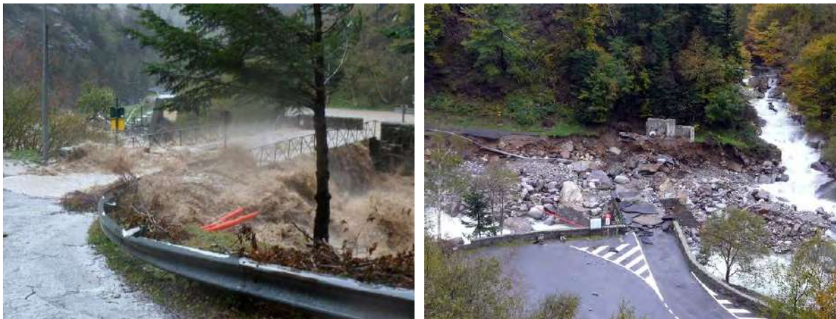
Destruction du Pont de Prat. Clichés pendant (à gauche) et après la crue (à droite) © SHEM
