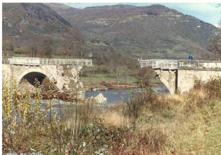
Fig. 32. Pont de Bazus-Aure emporté par la crue de novembre 1982
