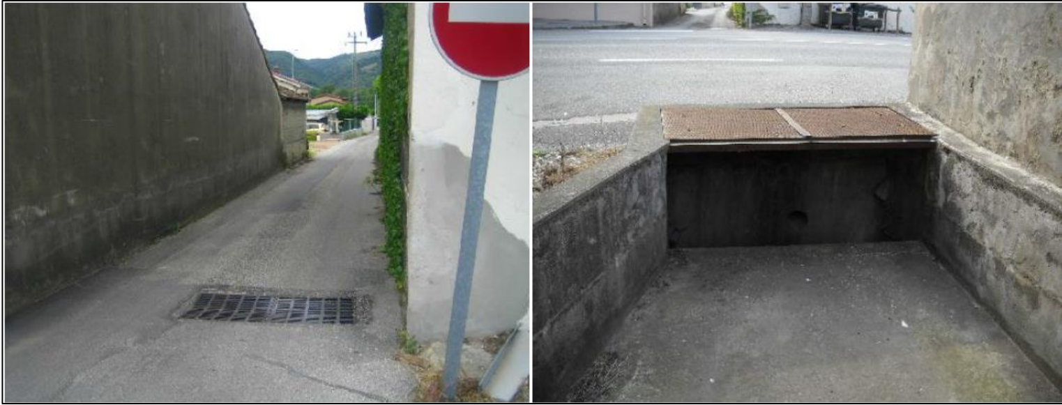
Figure 50 : Tampon de regard dans la plaine (gauche) et franchissement de la RN7 (droite) du ruisseau des Barres canalisé ( PPRI Servès sur Rhône)
