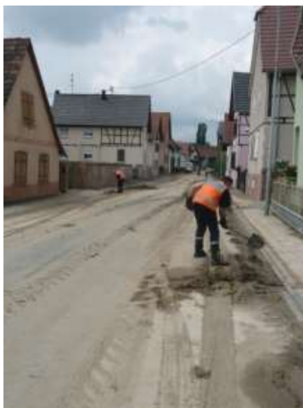
Figure 19 : Nettoyage de la voirie à Geudertheim après une coulée d'eau boueuse, 4 avril 2010
