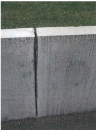
Figure 106 : Ouverture des joints entre deux éléments de murs
