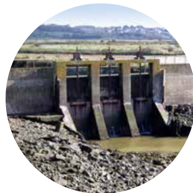
▲ Ouvrage du Milaret, marais du bassin de Guérande.
