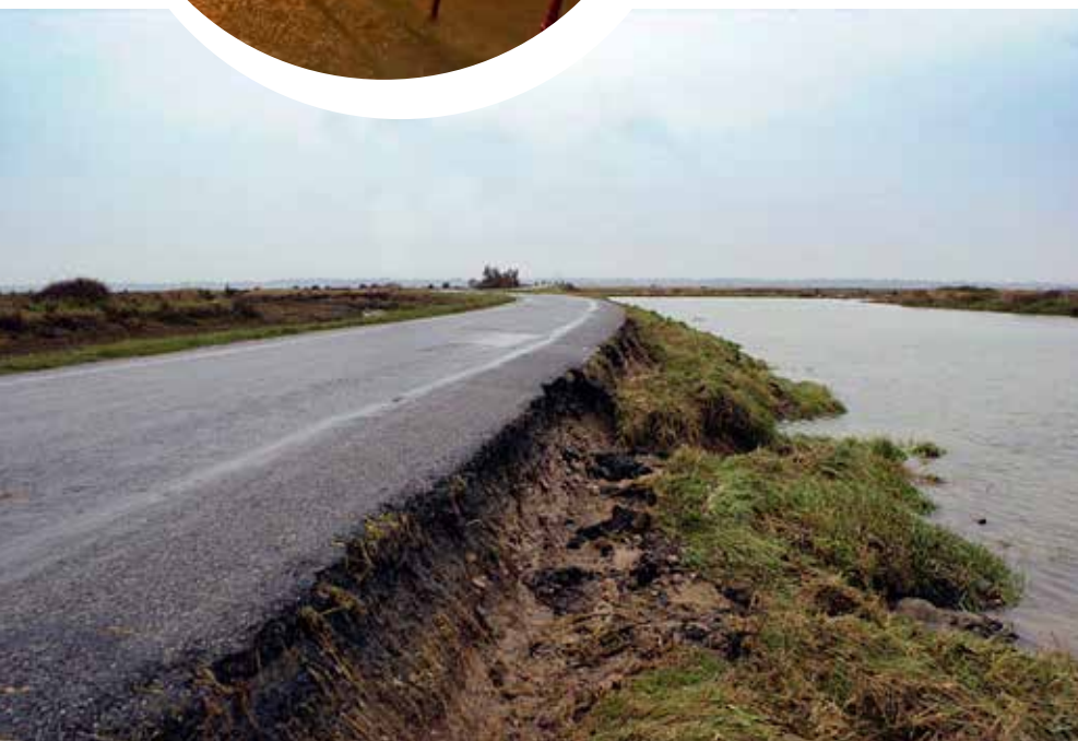
▲ Route endommagée des marais salants à Batz-sur-Mer.
