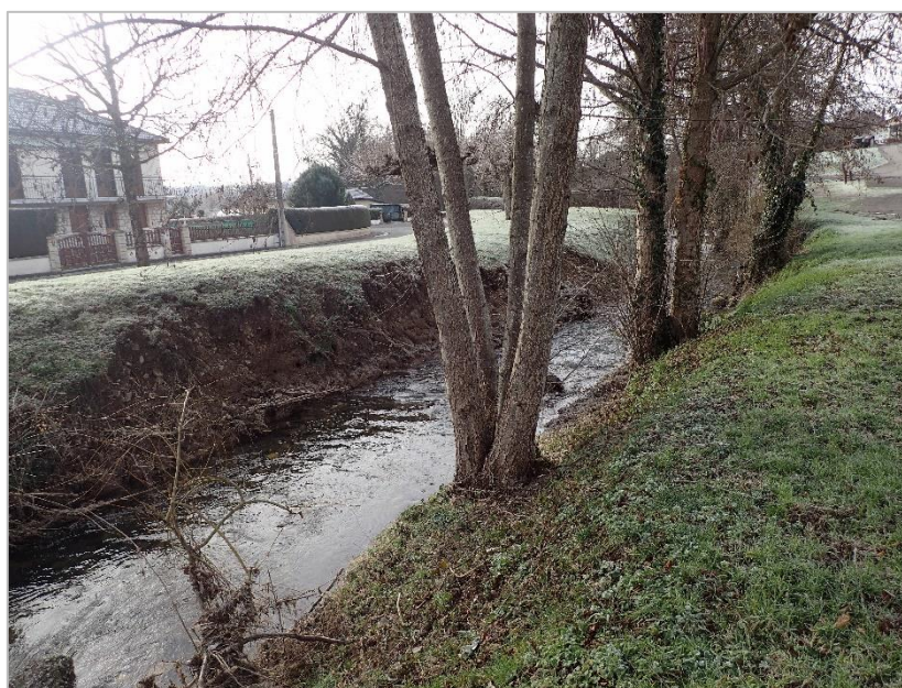
Figure 29 : État du merlon de protection après les crues de janvier 2018
