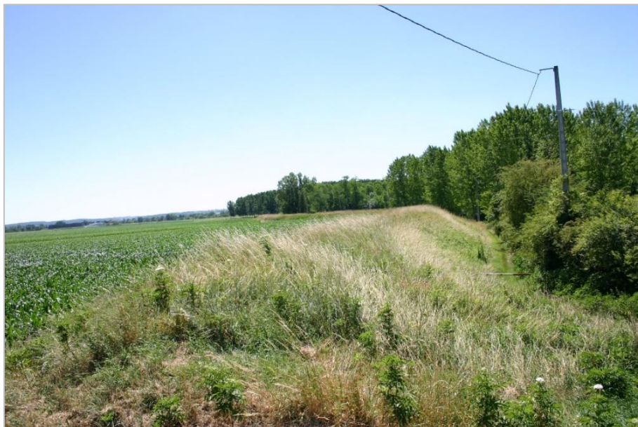
Figure 20 : « Digue de la basse plaine d'Aiguillon » sur la commune d'Aiguillon
