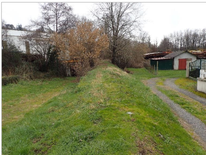
Figure 27 : Ouvrage de protection en amont de la zone artisanale de Bagnac-sur-Célé » (Photo : SmCLM)
