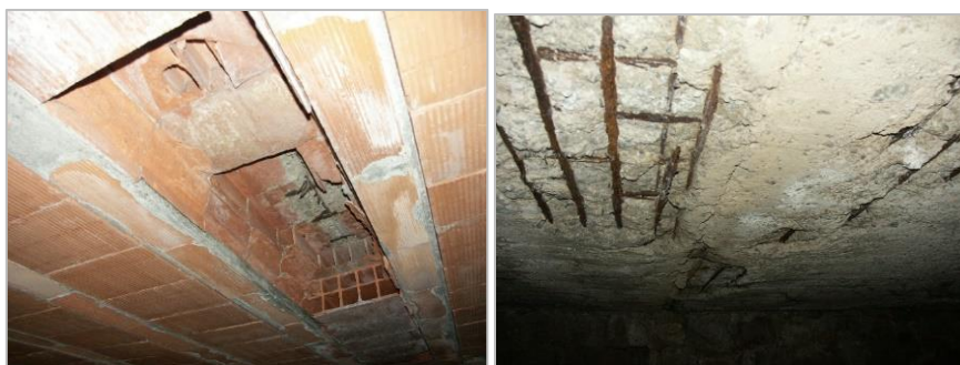
Figure 27. Intérieur du pont de la RD631 abimé (source : mairie d'Auzits)
