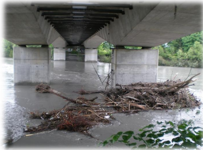
Figure 3. Exemple d'un embâcle sur un pont
