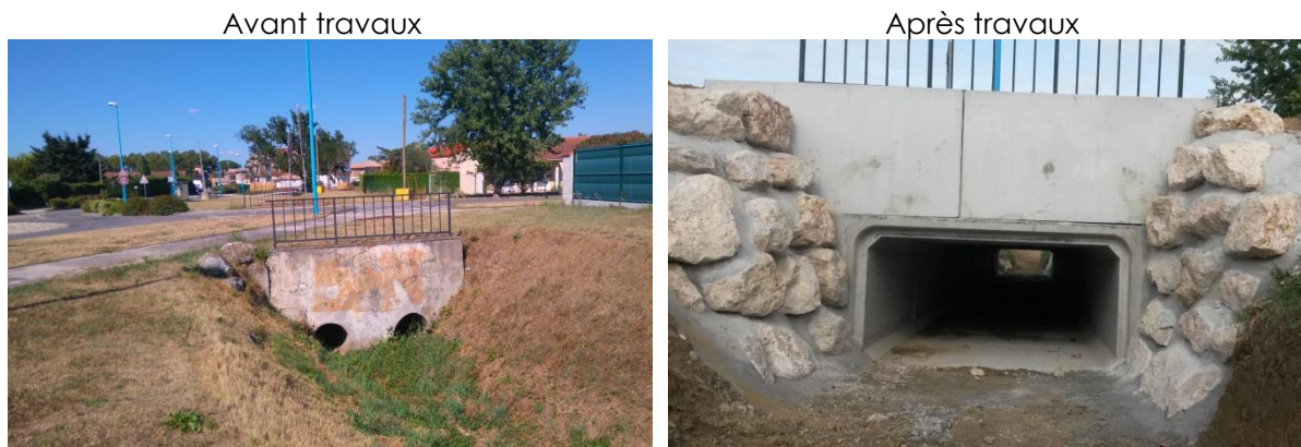
ILLUSTRATION N° 3 : OUVRAGE RÉDUISANT LES ÉCOULEMENTS DU SARASCLÉ À LABARTHE-SUR-LÈZE
