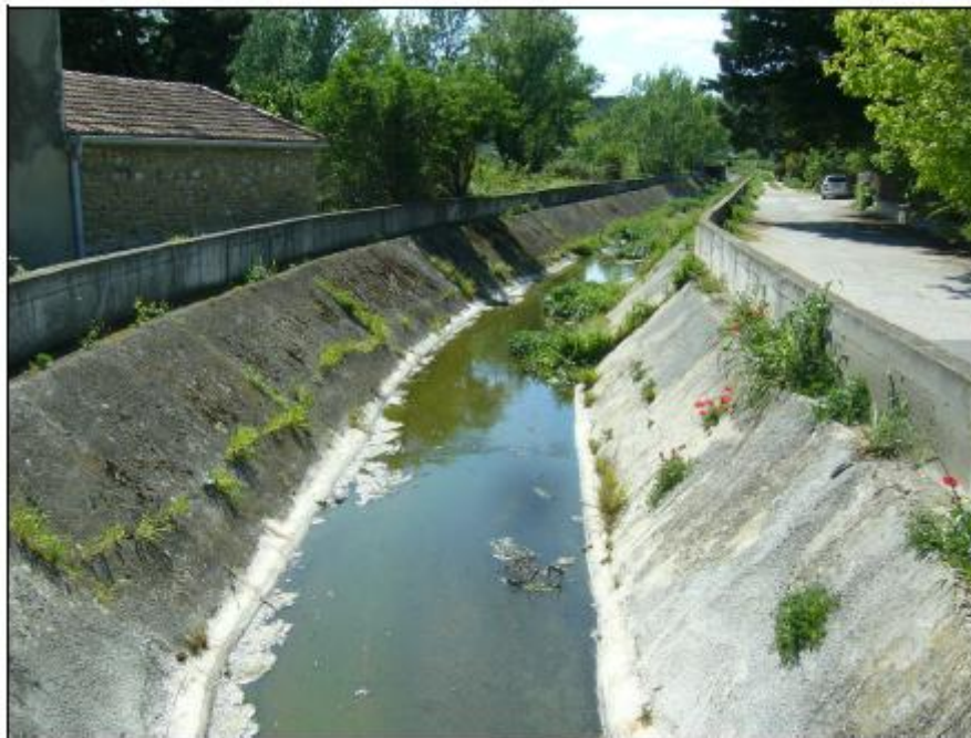
Figure 11 : Illustrations de la dégradation du canal de la Contre-Seille
