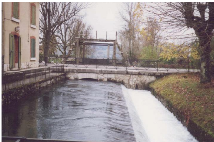
Déversoir latéral de sécurité en novembre 2002
