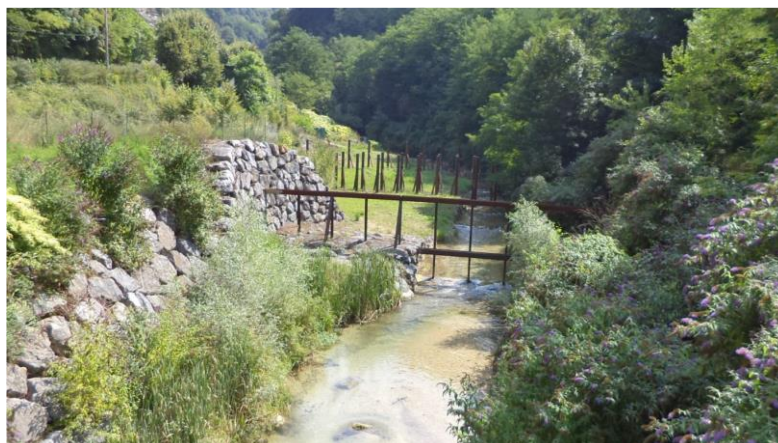
Plage de dépôt de la Morge en amont du centre de Voiron
