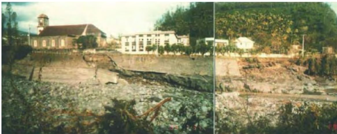
Erosion et affouillement de la digue de l'hôpital après le cyclone Firinga en 1989
