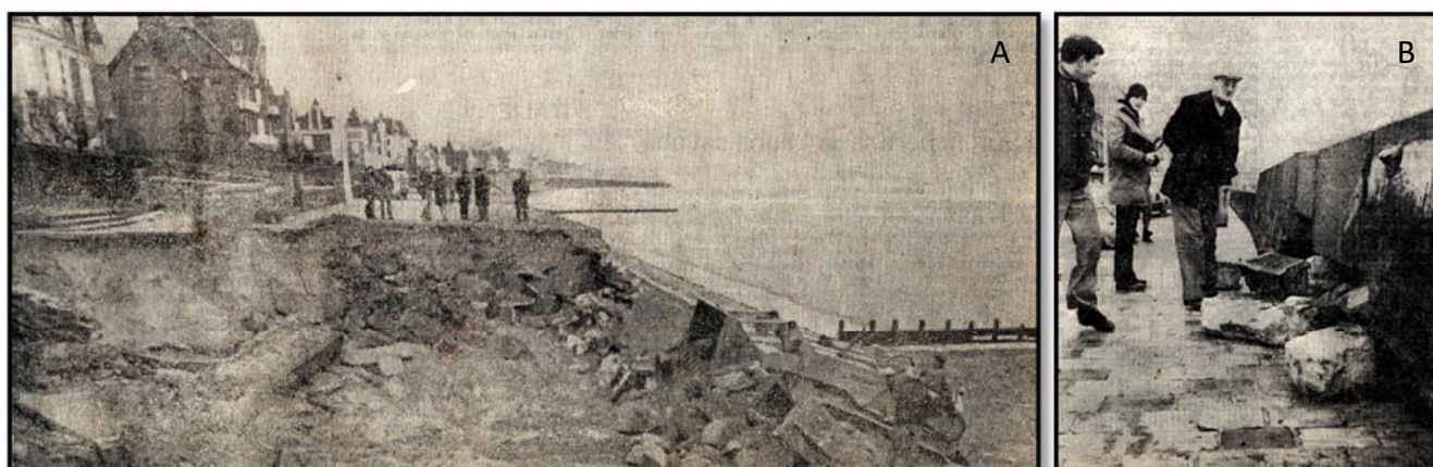
PLANCHE PHOTOGRAPHIQUE 2 : DEGATS SUR LES DIGUES PROVOQUES PAR LA TEMPETE DU 29 MARS 1979 PHOTOGRAPHIE A : BRECHES SUR LA DIGUE DE PARAME PHOTOGRAPHIE B : DESCHELLEMENT DE BLOCS DU PARAPET DE LA DIGUE DU SILLON (SOURCE : OUEST FRANCE, 30 MARS 1979)
