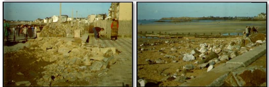
PLANCHE PHOTOGRAPHIQUE 3 : DEGATS OCCASIONNES PAR LA TEMPETE VIVIAN SUR LA DIGUE DE PARAMÉ (SOURCE : CNRS & BONNOT-COURTOIS, 1990)
