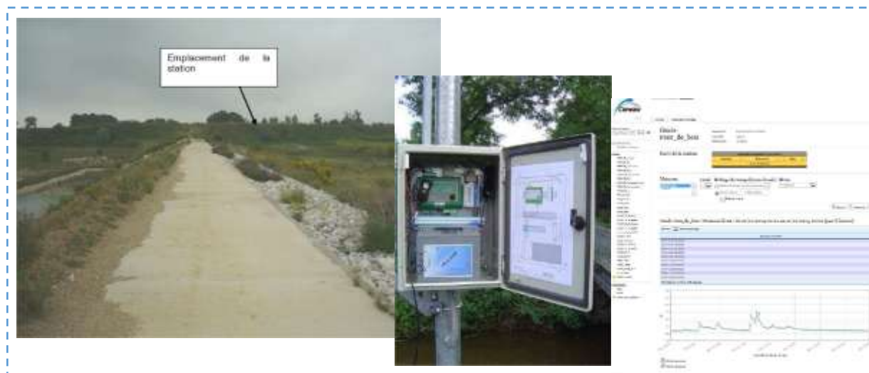
Figure 22 : dispositifs de surveillance des barrages de la Courragade
