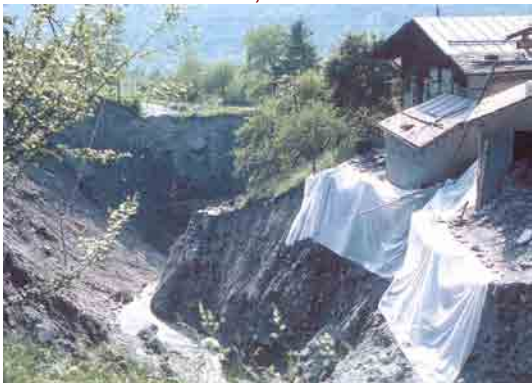
Photos 4.5, 4.6 : Affouillements Torrent de la Ravoire, 1981
