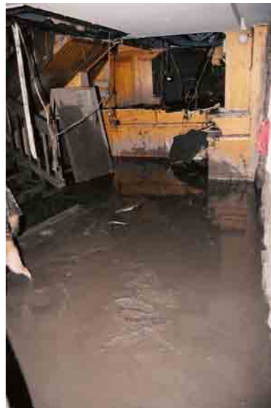
Les dégâts au niveau inférieur
