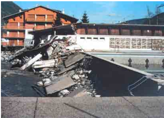
Photo 6.10 : Saint-Lary 1982, dégâts à la piscine
