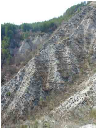
Photo 2.12 : Correction de versant à l'aide de banquettes grillagées – La Motte du Caire
